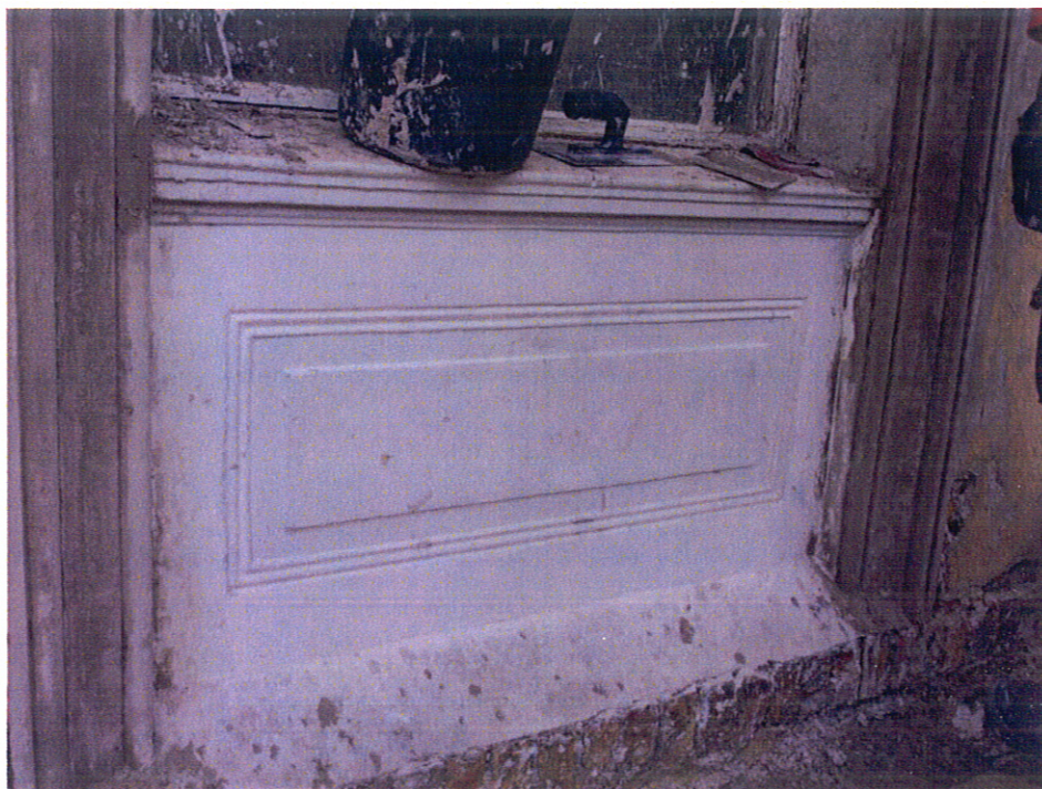
Fot. 14. Kętrzyn, Dworzec kolejowy, elewacja południowa, próba pokazania płytkiny podokiennej z nałożeniem gładkiej szpachłówki, mającej zabezpieczyć spękania i wyrównać powierzchnię.
