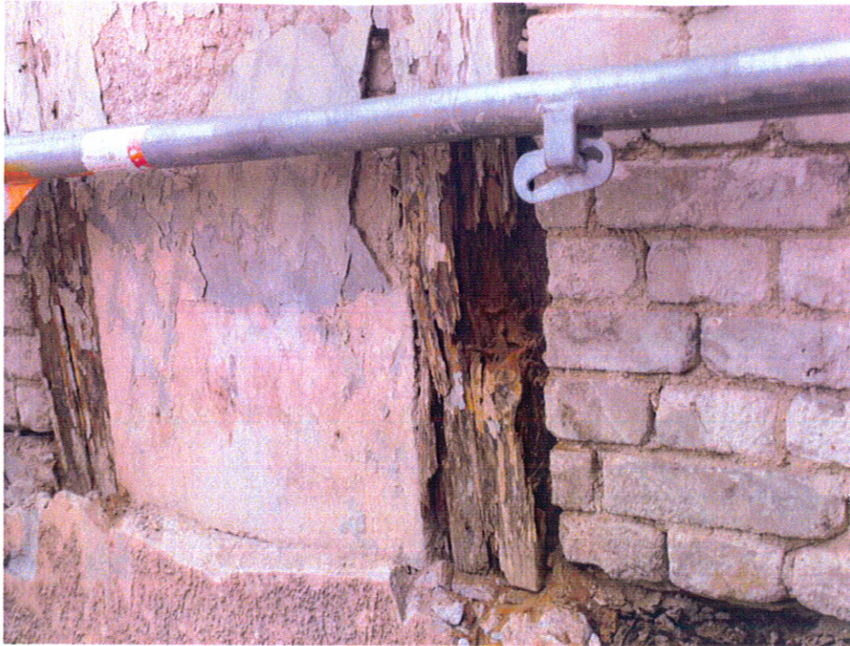
Fot. 11. Kętrzyn, Dworzec kolejowy, ściana ryglowa przybudówki wschodniej, zbliżenie na drewno, które jest zbutwiałe i zjedzone przez owady.
