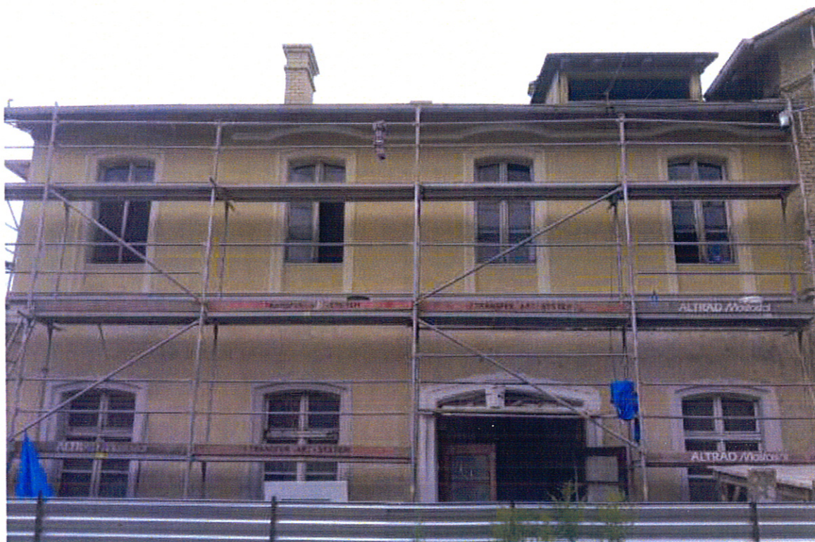
Fot. 16. Kętrzyn, Dworzec kolejowy, elewacja północna, próba kolorystyczna na nowo założonych tynkach w strefie piętra.
