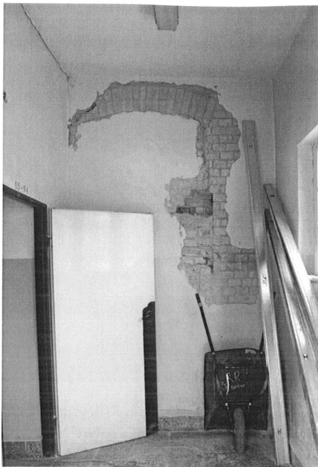
Fot. 7. Kętrzyn, Dworzec kolejowy, ściana przybudówki wschodniej, odkrywka pokazuje zachowany otwór okienny z nadprożem. Mur ceglany oraz spoina zachowały się tu w bardzo dobrym stanie.
