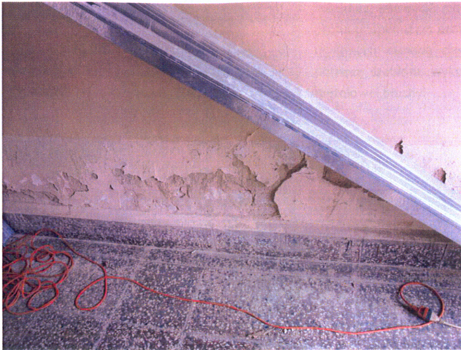
Fot. 13. Kętrzyn, Dworzec kolejowy, ściana ryglowa przybudówki wschodniej od strony wewnętrznej, widoczne zawilgocenie dolnej partii ściany, powodujące dezintegrację tynków i odparzenie warstw malarskich.
