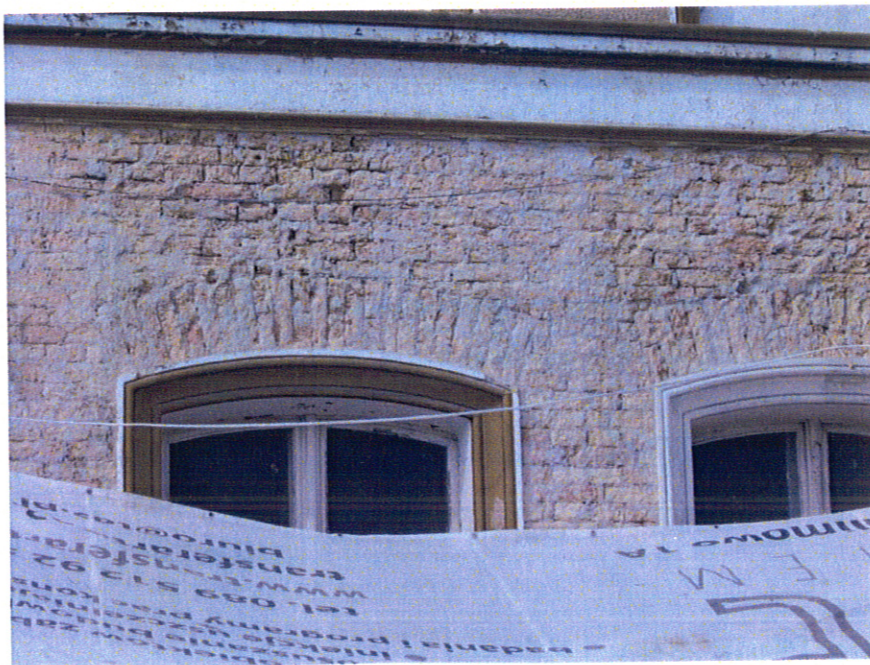
Fot. 2. Kętrzyn, Dworzec kolejowy, elewacja południowa, widoczna silna destrukcja cegieł nad nadprożem okiennym, cegły są silnie spękanie w całej strukturze i całkowicie pozbawione lica.
