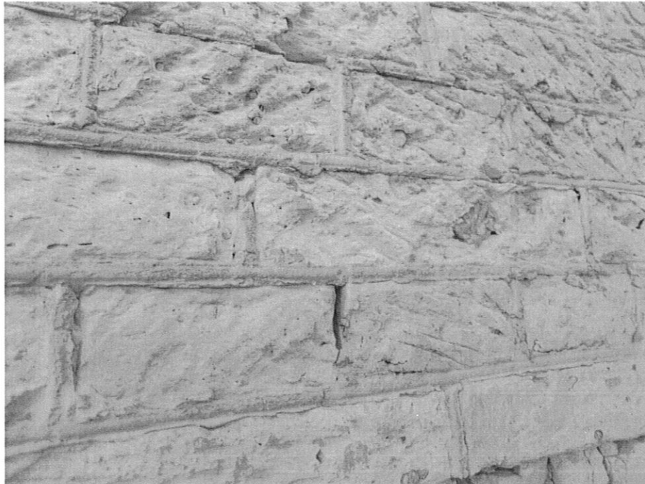
Fot. 4. Kętrzyn, Dworzec kolejowy, elewacja południowa, widoczny fragment muru gdzie cegła uszkodzona jest tylko powierzchniowo, widoczne ślady od młotkowania mające ułatwić narzucanie i zwiększyć przyczepność tynku. Widoczna dobrze zachowana pierwotna spoina, lecz miejscowo roszczenia.
