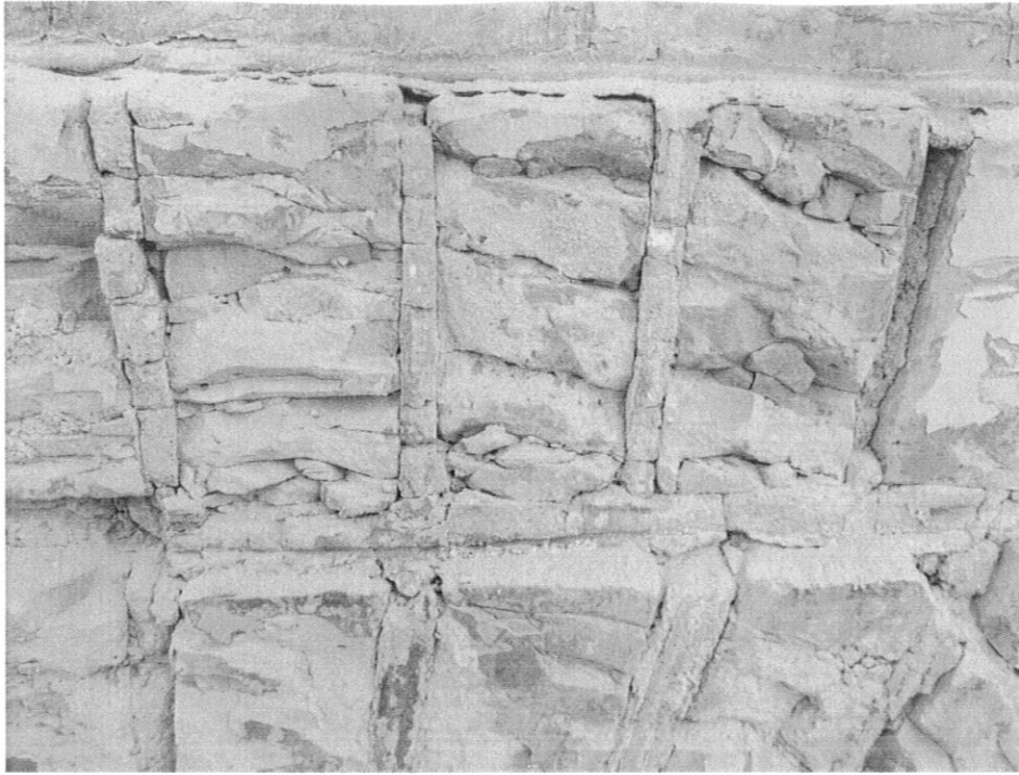
Fot. 3. Kętrzyn, Dworzec kolejowy, elewacja południowa, widoczny fragment rolki po odświeżeniu z wtórnych tynków, widoczna silnie spękana cegła, która rozwarstwiła się w swojej strukturze. Widoczna także zachowana spoina z opracowaniem w formie wałka.
