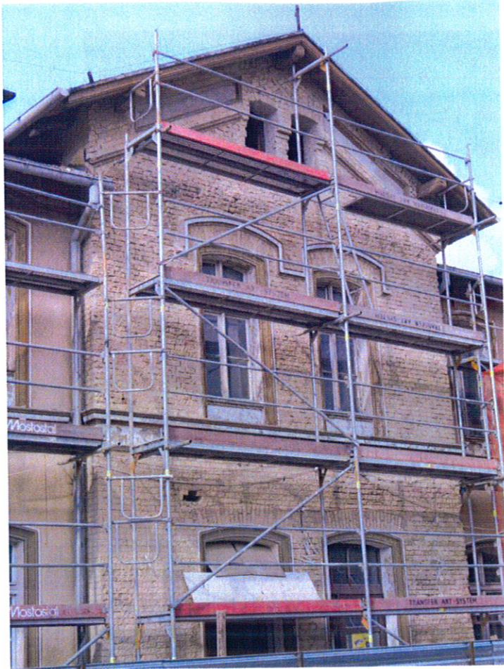
Fot. 1. Kętrzyn, Dworzec kolejowy, elewacja południowa, ryzalit zachodni, po skuciu tynków prostych. Widoczny zły stan zachowania cegieł. Cegły są silnie uszkodzone mechanicznie pod wtórny tynk, liczne spękania ich struktury.
