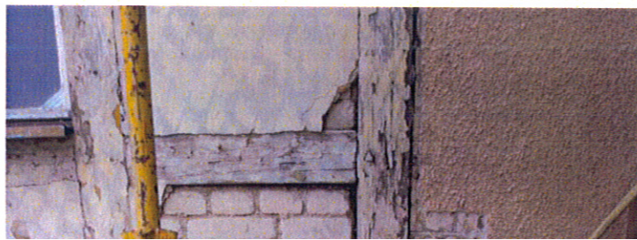
Fot. 10. Kętrzyn, Dworzec kolejowy, ściana ryglowa przybudówki wschodniej, widoczna silna destrukcja dolnej części belek. Konstrukcja ryglowa wypełniona jest białą cegłą
