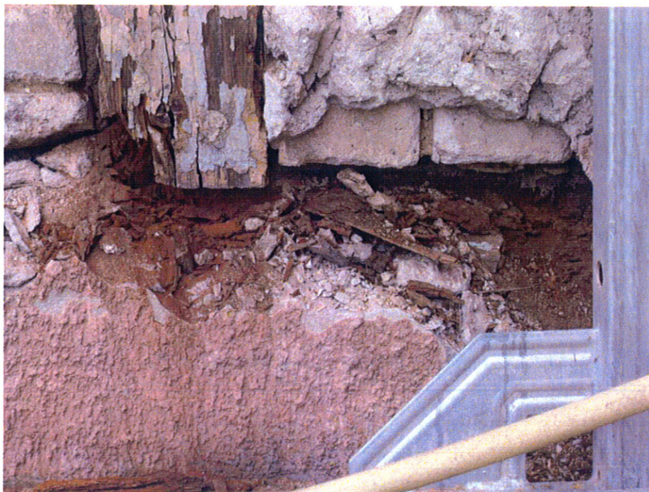
Fot. 12. Kętrzyn, Dworzec kolejowy, ściana ryglowa przybudówki wschodniej, ze słupów konstrukcji ryglowej wysypuje się mączka drewniana.
