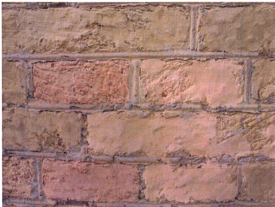
Fot. 6. Kętrzyn, Dworzec kolejowy, elewacja południowa, widoczny fragment muru z próbą założenia kitów zabezpieczających cegłę przed dalszą destrukcją.
