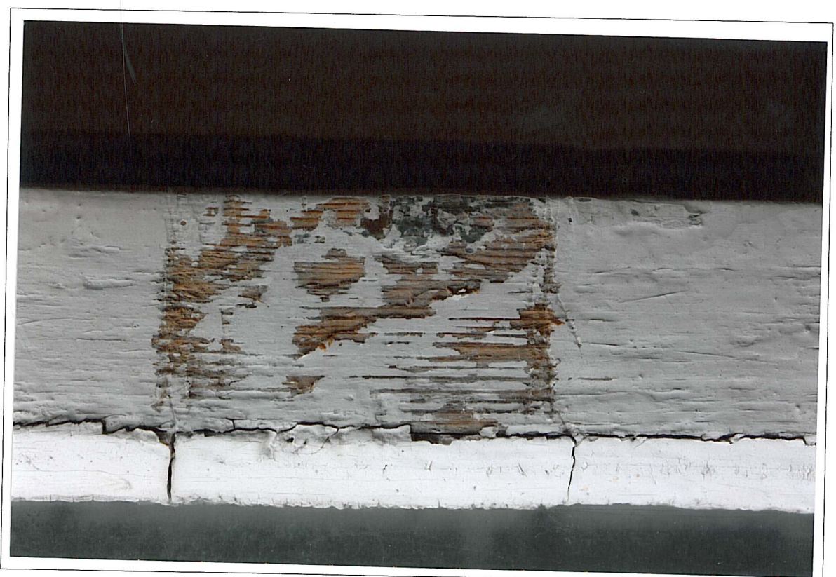
W odkrywcę widoczna śladowo zachowana, szara kolorystyka stolarki okiennej
