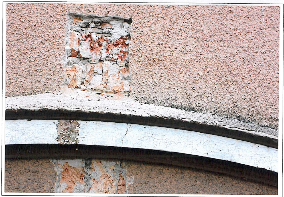
Dworzec kolejowy w Kętrzynie – ściana północna ryzalitu zachodniego, poziom I piętra nad oknem. W odkrywce widoczny stan zachowania powierzchni elewacji
