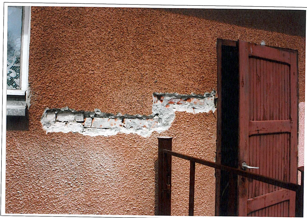
Dworzec kolejowy w Kętrzynie; budynek gospodarczy, ściana południowa – w odkrywcę widoczne przemieszane wątki ceglane. Brak śladów pierwotnego tynku
