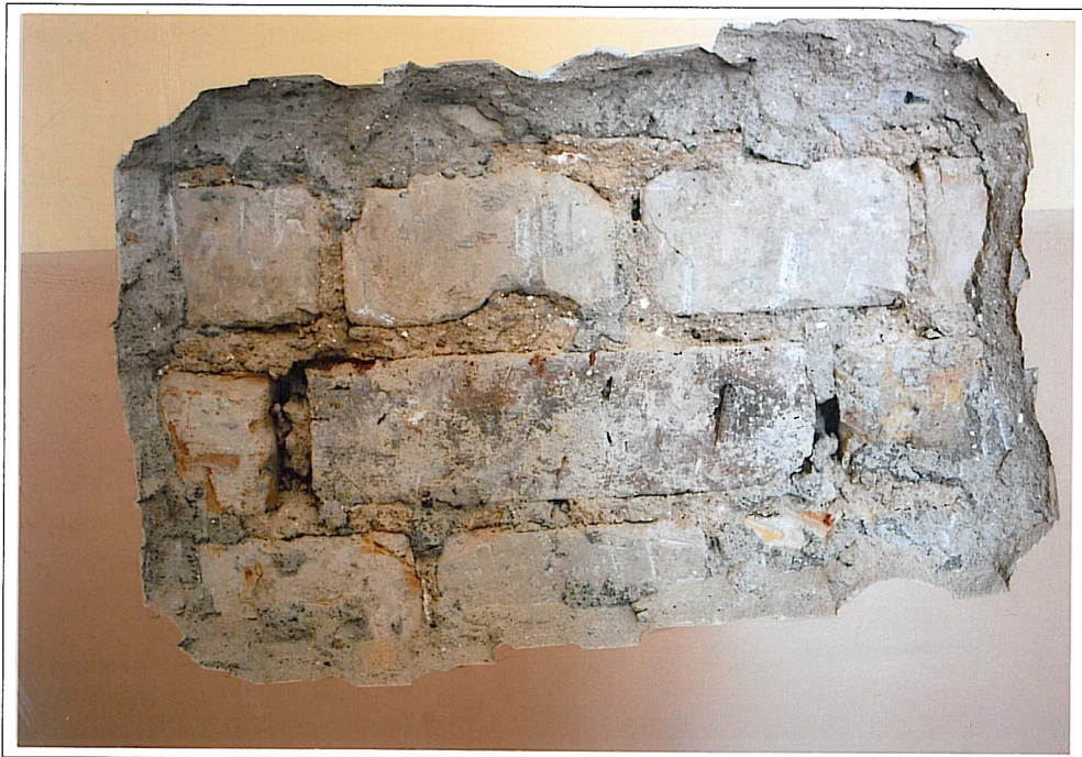
Dworzec kolejowy w Kętrzynie – bryła centralna. parter; ściana wewnętrzna pozbawiona pierwotnego tynku
