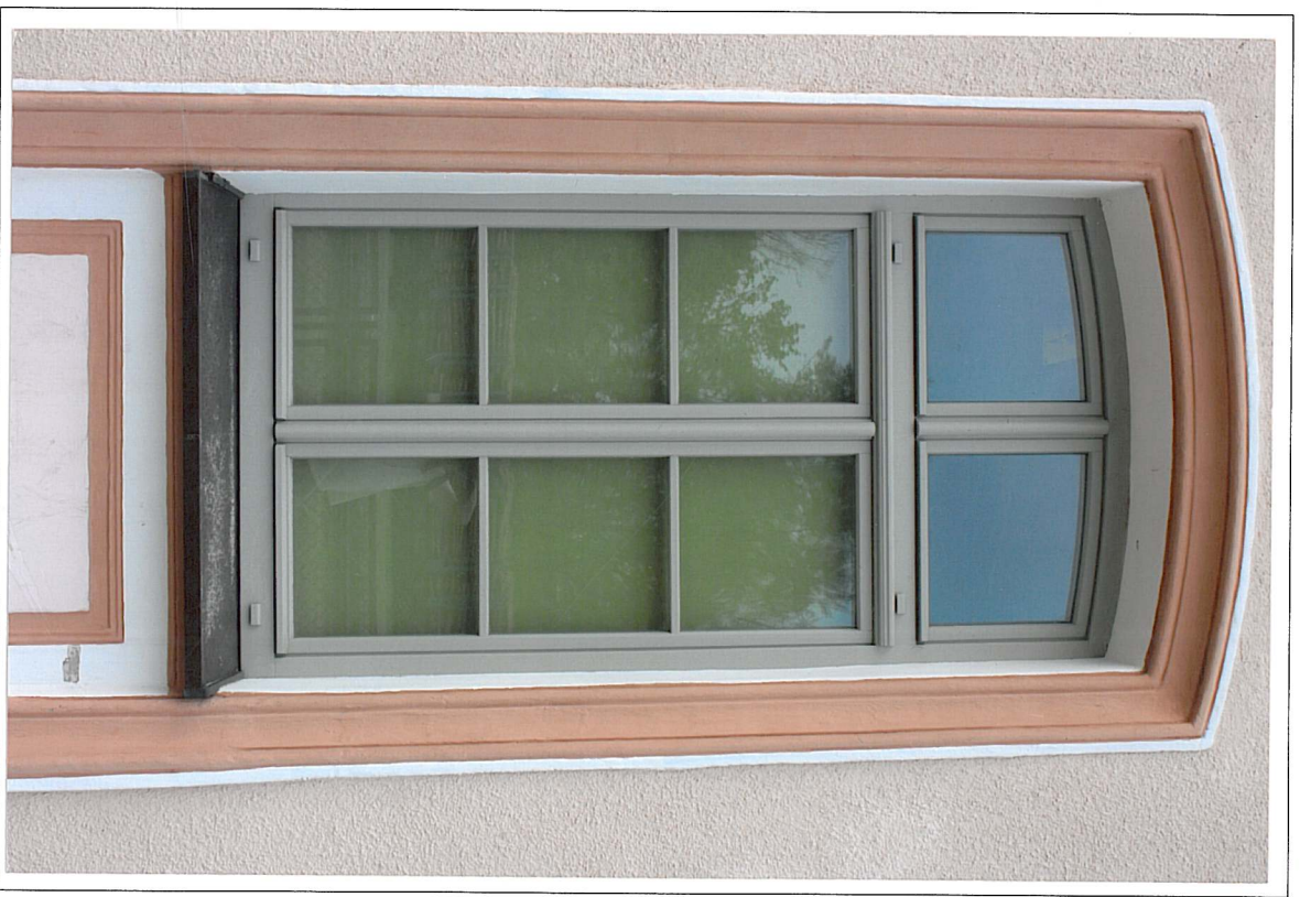
parterowa przybudówka od strony zachodniej; współczesna stolarka okienna nawiązująca podziałami i kolorystyką do stolarki historycznej
