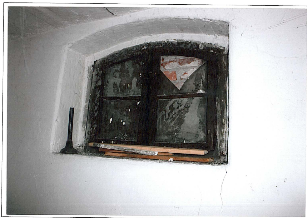
Dworzec kolejowy w Kętrzynie, budynek gospodarczy, część wschodnia, ściana południowa - okno zamurwane od zewnątrz
