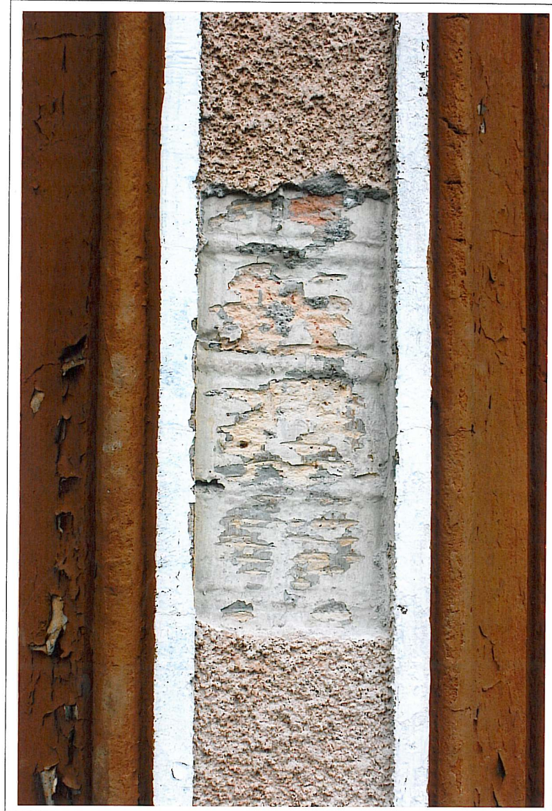
Dworzec kolejowy w Kętrzynie – ściana wschodnia ryzalitu wschodniego, poziom I piętra. Widoczny wążek ceglany między opaskami okiennymi. Warstwy malarskie nakładane bezpośrednio na cegły i fugi. Widoczne celowe zniszczenia (fakturowanie !) powierzchni cegieł
