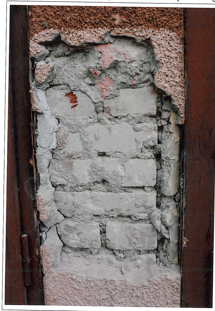
Dworzec kolejowy w Kętrzynie, budynek gospodarczy, ściana południowa – przemurowanie z przypadkowych materiałów (cegły czerwone i białe)
