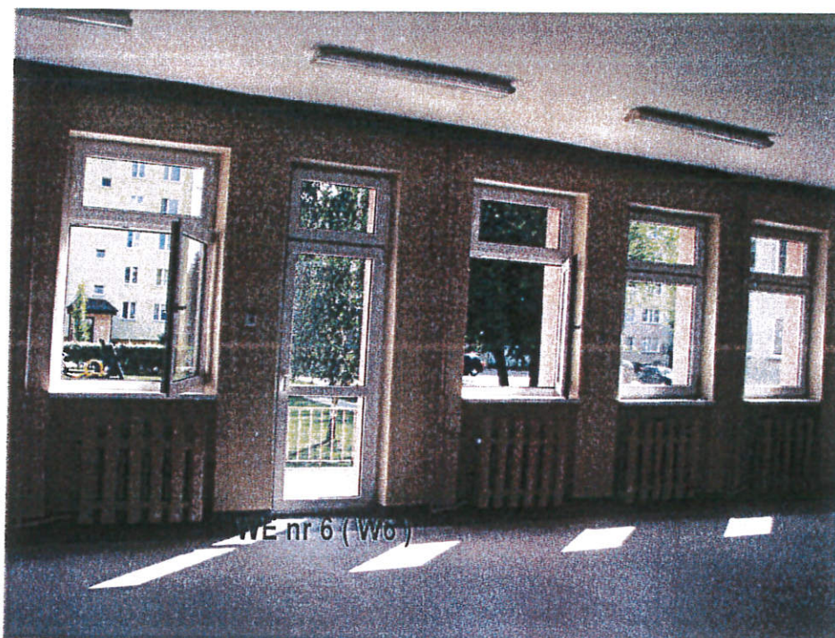
Zdjęcie nr 7 Widok drzwi osadzonych na wyjściu ewakuacyjnym z sali czterolatków wyjście ewakuacyjne, oznaczone jako wyjście ewakuacyjne WE nr 6 ( W6 )
