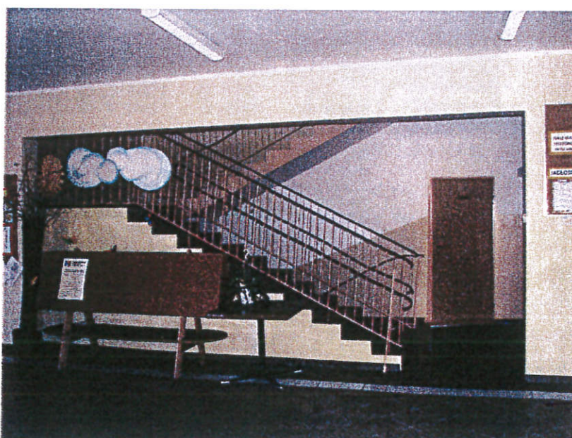
Zdjęcie nr 8 Widok ogólny klatki schodowej KL 1 w poziomie I kondygnacji nadziemnej
